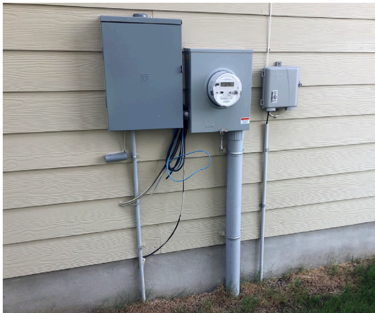
Líneas Subterráneas Conectadas a Medidor Eléctrico
